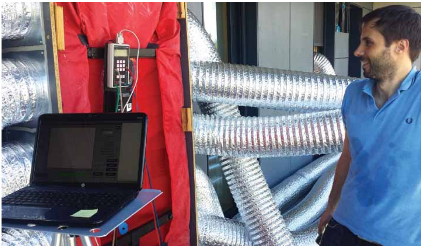
Slika 1: Pri gradnji sodobnih stavb, sNES, je pomemben vidik ciljno doseganje zelene zrakotesnosti ovojja stavbe – izvedba testa zrakotesnosti. Foto: GI ZRMK
